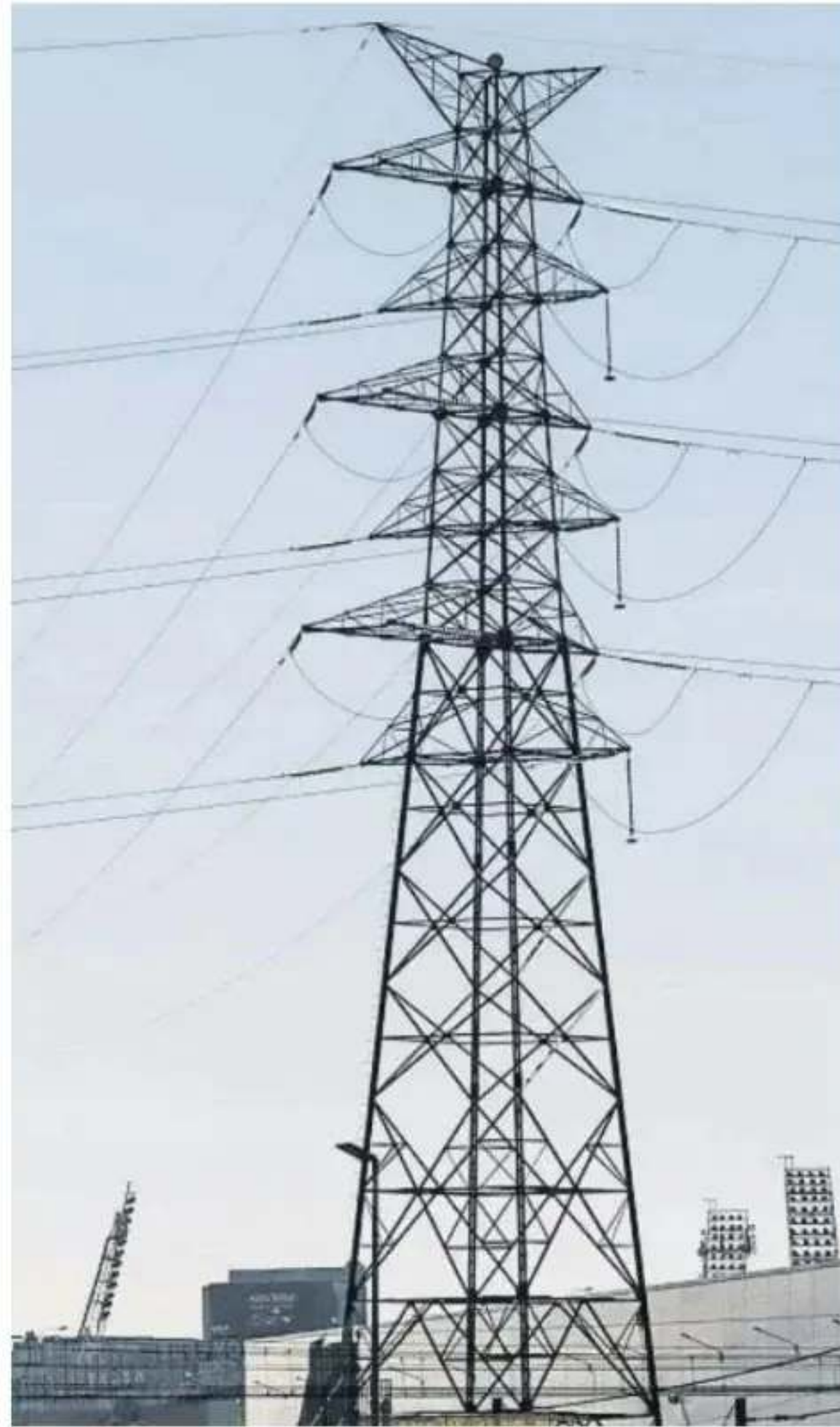
Torre de alta tensión
